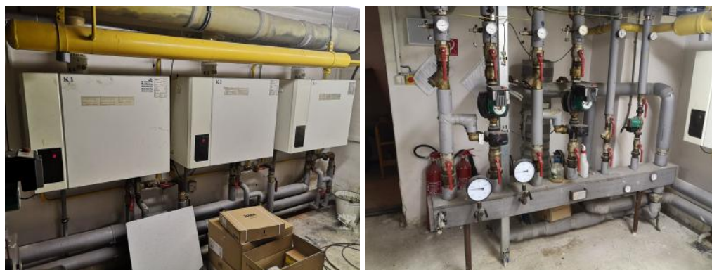
Obr. 8. Tepelné zdroje a vybavenie kotolne
