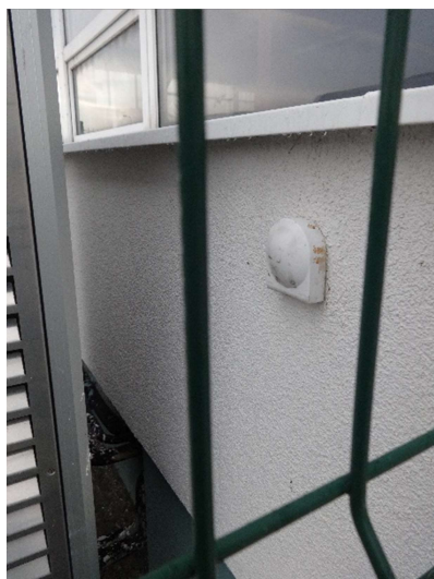
Obr. 7 Vonkajší snímač teploty vzduchu pre riadiaci systém kontroly zdrojov tepla centrálnej kotolne
