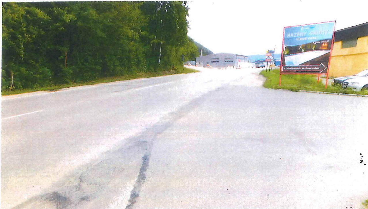
Štátna cesta č. II/507 – prieťah Oblasťou ľahkého priemyslu, severná časť novoutvorenej KN-C parc. č. 1248/27 na hranici katastrálnych území Orlové a Považské Podhradie – pohľad od juhu
