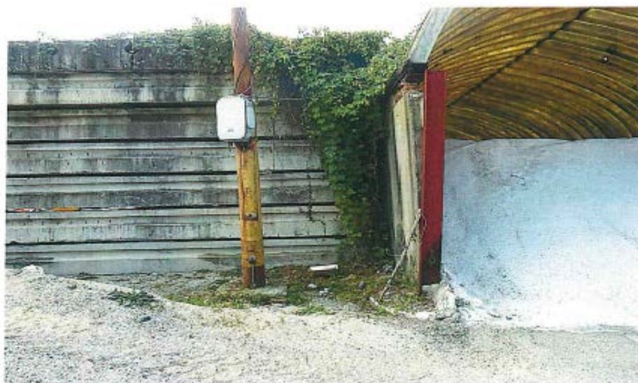
Obr.č.3 Detail nosnej konštrukcie skladu /krajný oceľový stĺpik I 180/ /deformácia zvislej betónovej steny/
