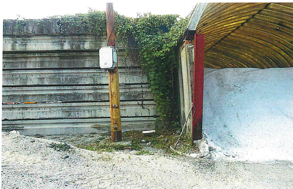
Obr.č.3 Detail nosnej konštrukcie skladu /krajný oceľový stĺpik I 180/ /deformácia zvislej betónovej steny/
