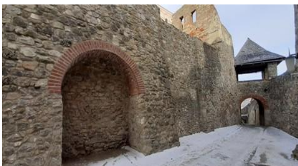
Obnova vybraných objektov v juhovýchodnej časti hradného jadra na NKP Trenčiansky hrad, po rekonštrukcii
