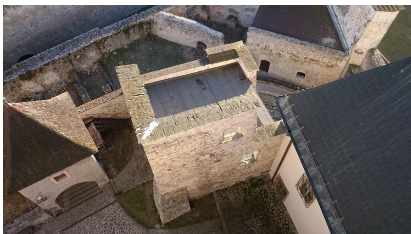
Obr. č. 3: Výmena šindľovej krytiny na 5. bráne a letnej veži stav pred zásahom
