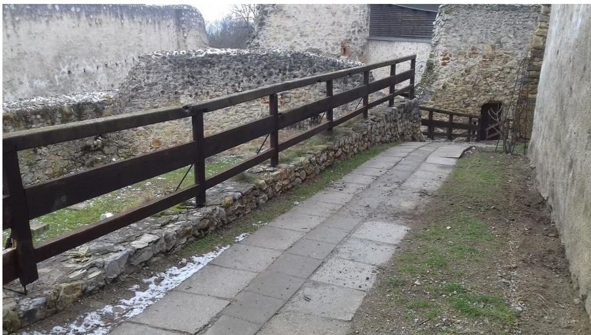
Obr. č. 11: Oprava dreveného zábradlia medzi IV. a V. bránou – pred zásahom
