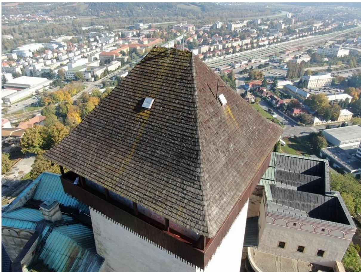
Obr. č. 5: Oprava zastrešenia Matúšovej veže – pred zásahom
