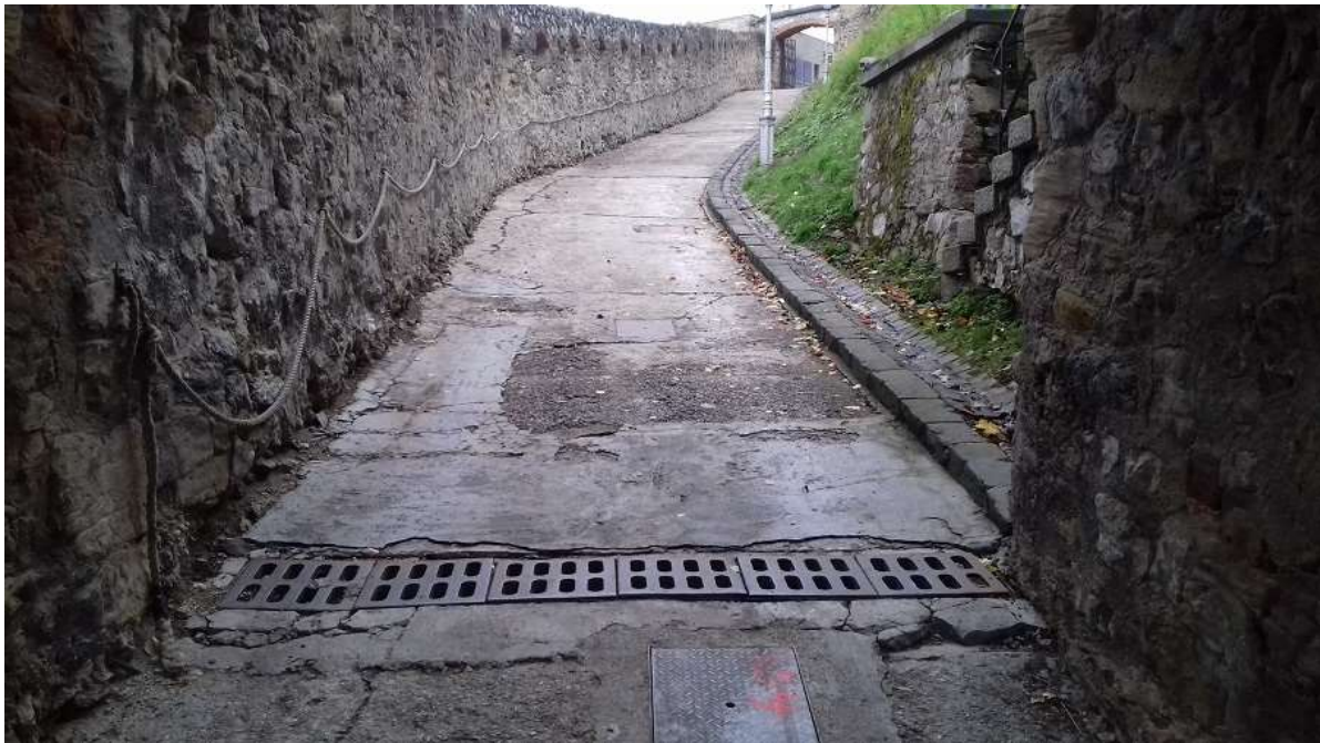
Obr. 1: Výmena vodovodnej prípojky na Trenčiansky hrad – II. etapa, pôvodný stav
